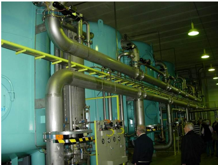
Wasserversorgungsanlage Nördl. Wienerfeld (NWF):
